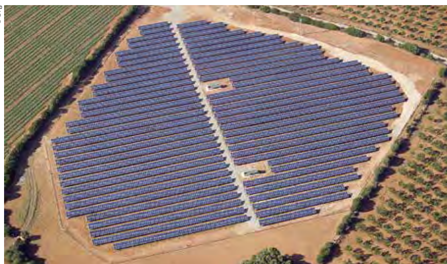
Die Anlage wurde möglichst optimal ins Landschaftsbild integriert.
